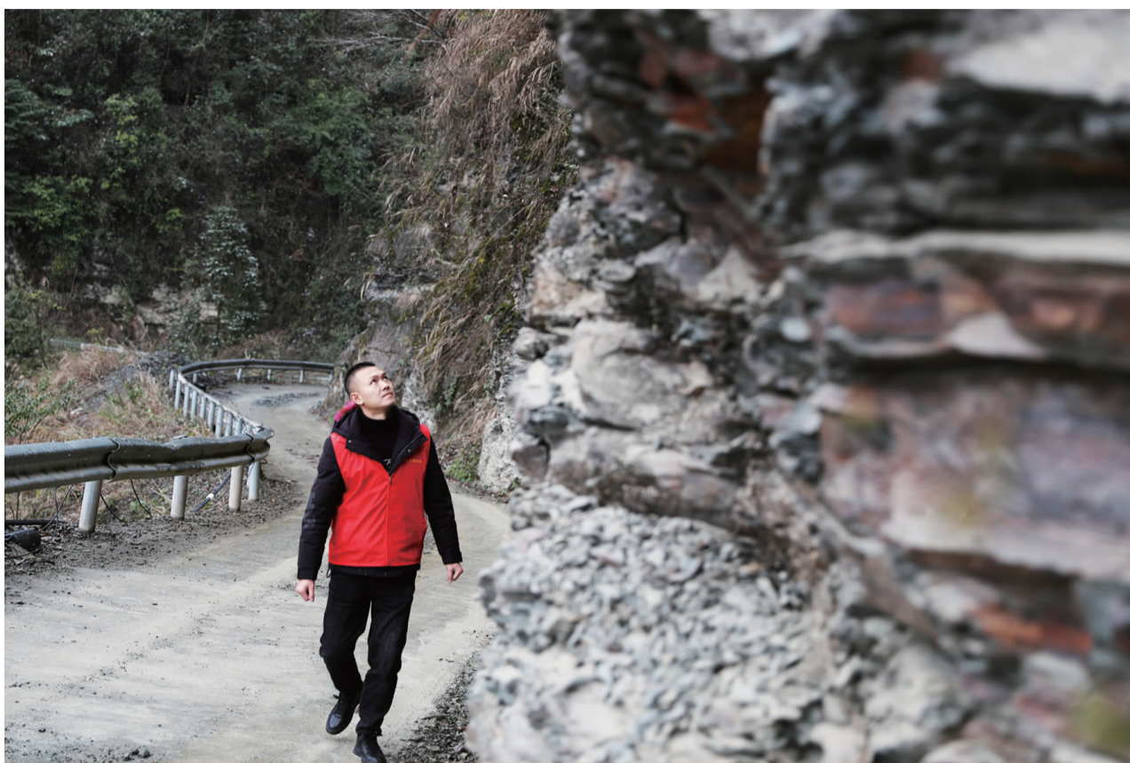
1月17日，谢宗旬正在察看公路边坡垮塌情况。
