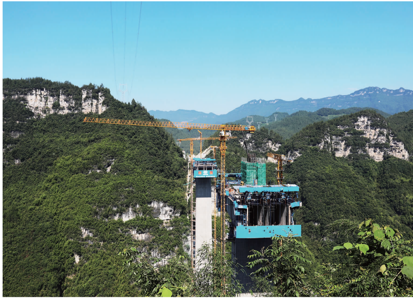
7月17日,渝湘复线高速公路磨寨乌江特大桥桥梁施工现场,工人们正加紧施工。项目建成通车后将极大缓解老渝湘高速的通车压力,进一步便捷沿线区县的交通运输,促进沿线经济社会高质量发展。
