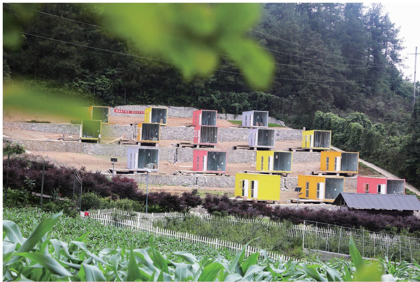
近日,在润溪乡樱桃井村寻梦山谷农业休闲度假中心的露营地,施工人员忙着铺装道路、整理造型,以尽早建成露营地。据了解,寻梦山谷休闲农业休闲度假中心总占地220亩,有户外咖啡、钓鱼基地、亲子松鼠乐园等集生态旅游、观光休闲、农事体验等于一体,实现以农促游、以游带农、深度融合。
